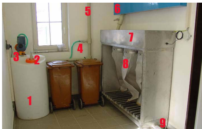
SDP 3 Installerad vid reningsverk i Tjekien – 800 P.E.
